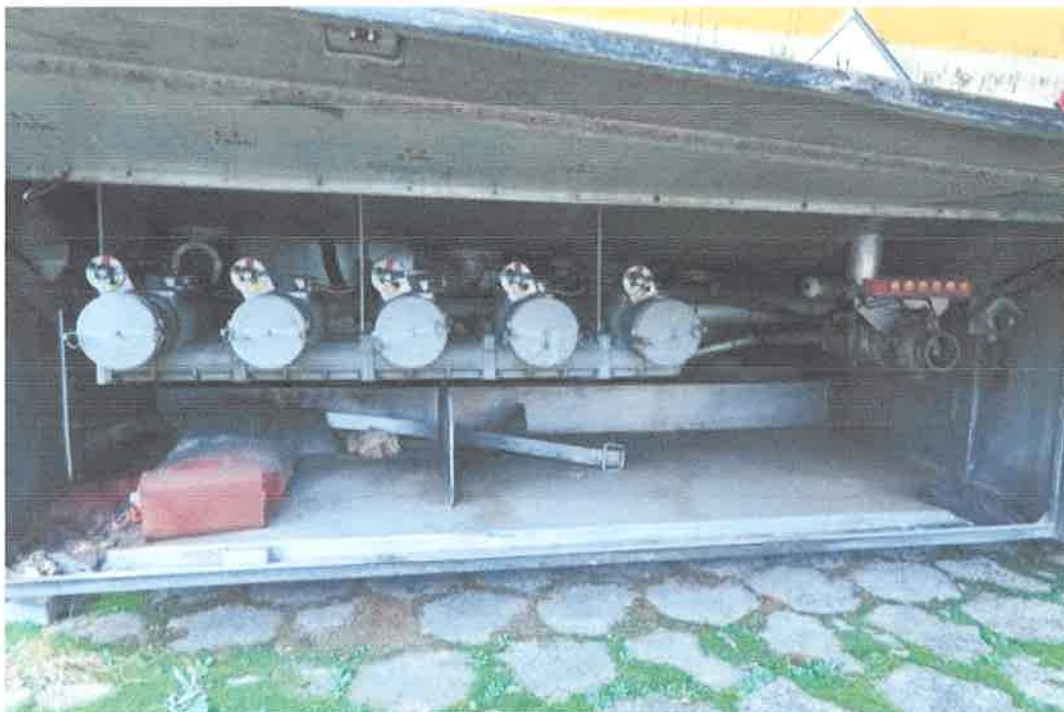
14 System dystrybucyjno - pomiarowy.
