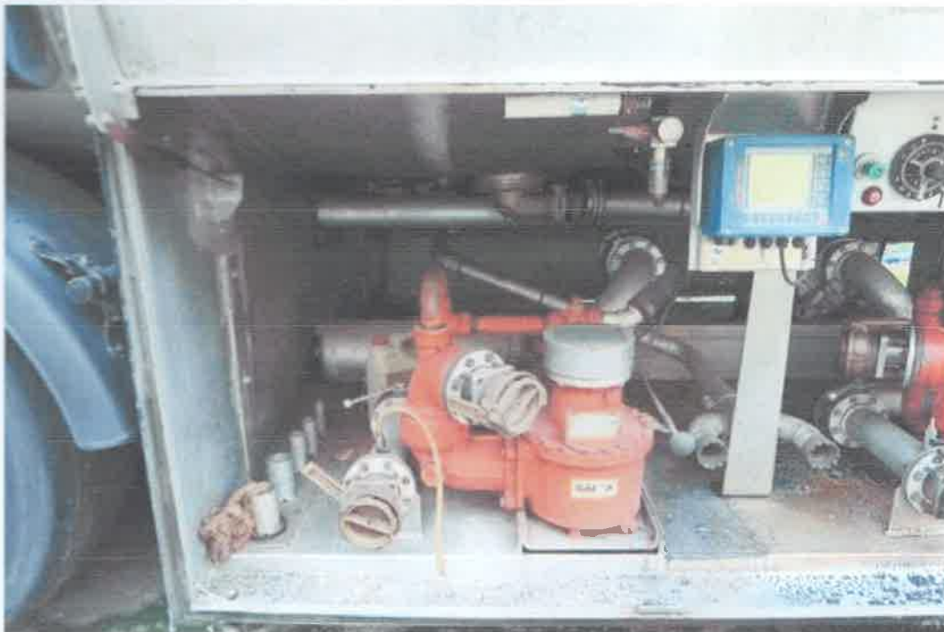
10 System dystrybucyjno - pomiarowy.
