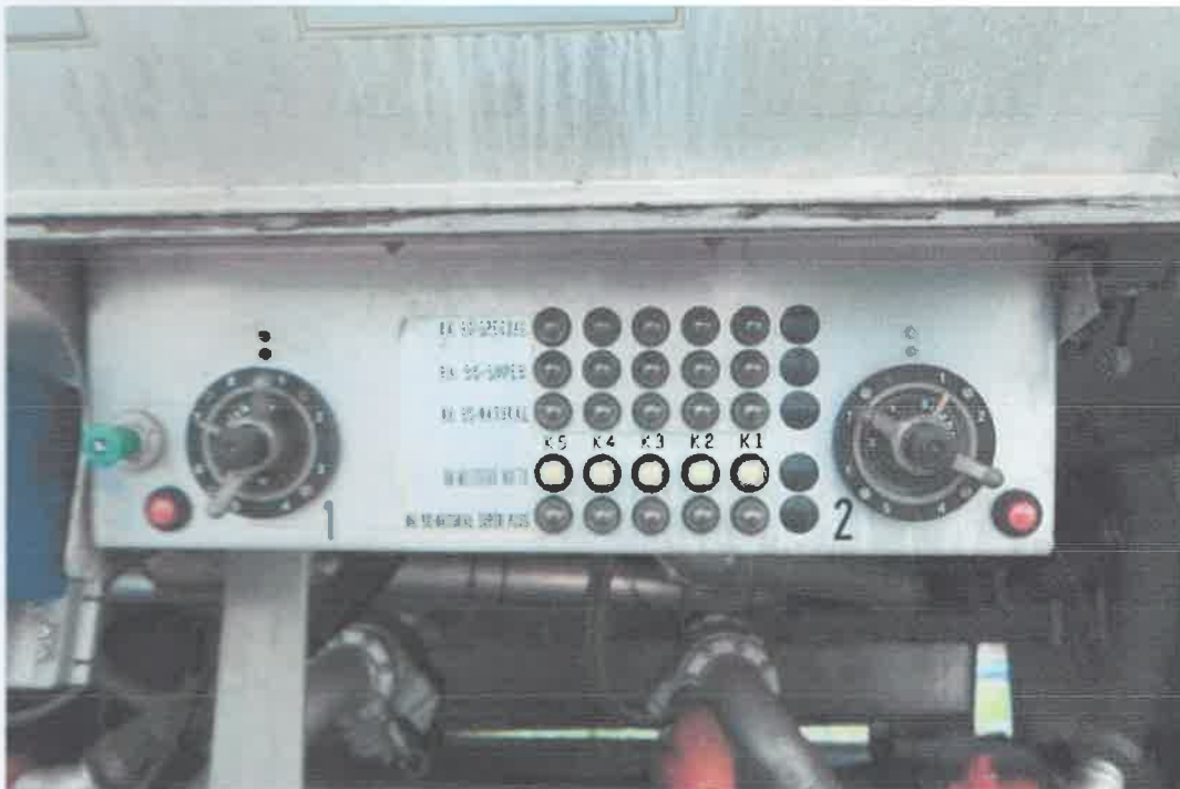
12 System dystrybucyjno - pomiarowy.
